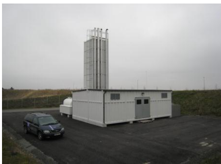
Figur 6. Panncentralen (Kvänum energi, 2011)
